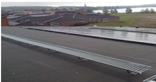
Solpanelerna sedda från skoltaket
